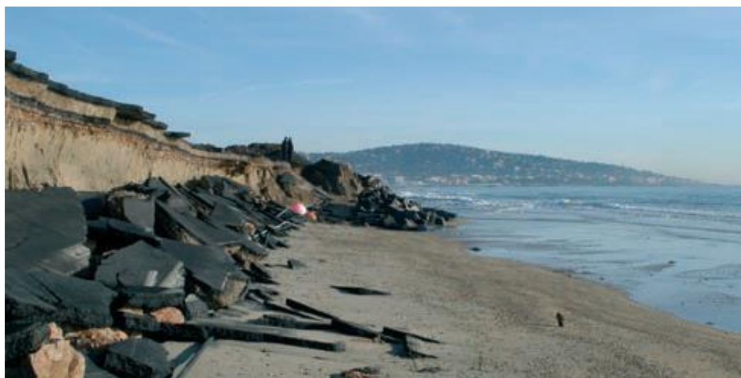
Figure 11 : route côtière coupée suite à la tempête de décembre 1997 dans le secteur du Château de Villeroy
